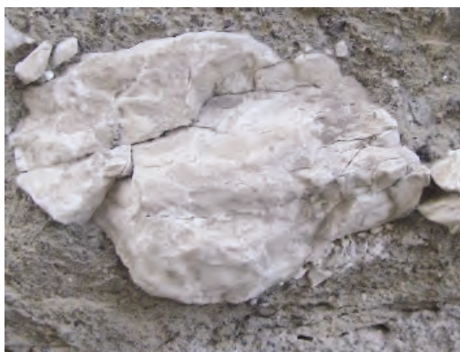
Particolare di un muro nel centro storico di Ariccia con inclusi messi in rilievo dall'azione degli agenti meteorici.
